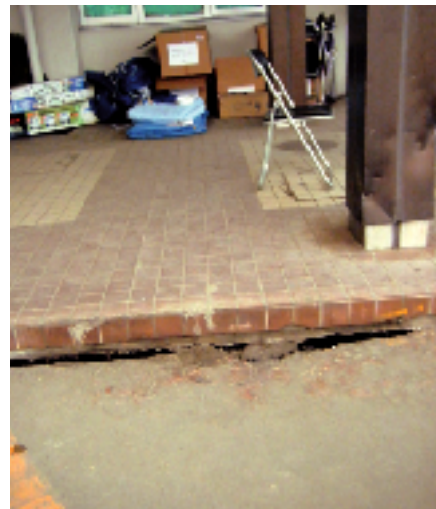
地震により救急室搬入口に段差ができる
