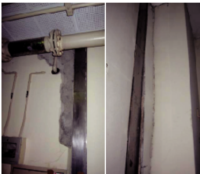
2階エキスパン（破損・ひび割れ）
